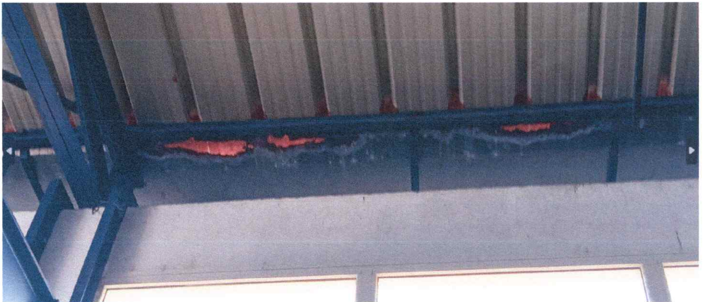
MAUVAISE ETAT DU CHENEAU EXISTANT
